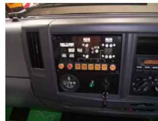
発電機 始動停止スイッチ（改造）
