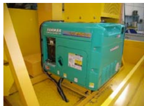
防音型発電機（320ccディーゼルエンジン）を搭載。100Vを24Vに変換し車両バッテリーに供給（改造）
