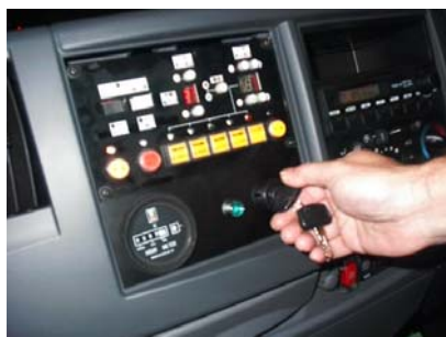
発電機スイッチON
